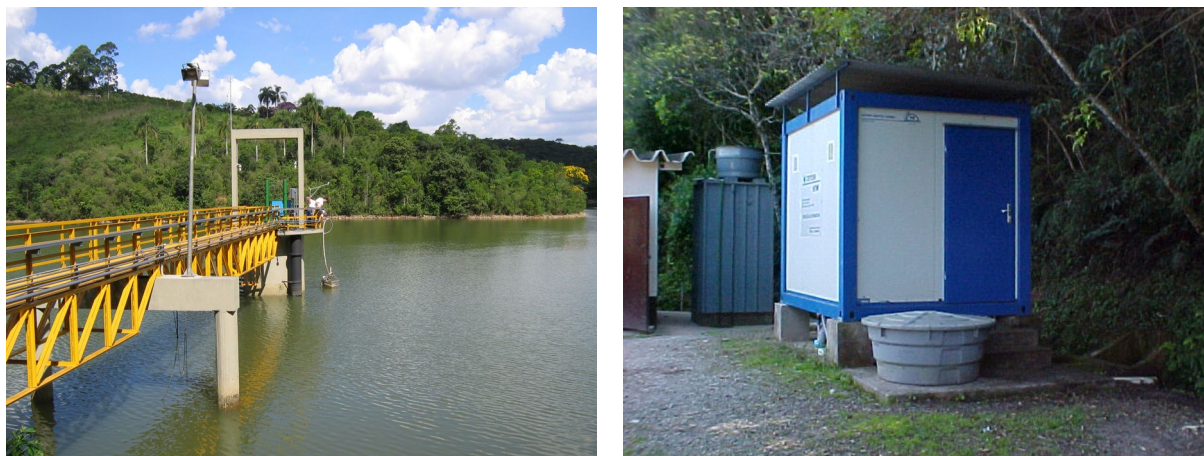
Figura 3.6 – Registro fotográfico da Estação Automática EF. 09–ACLA 00900–AGUAS CLARAS (Foto: C.L. Midaglia)
