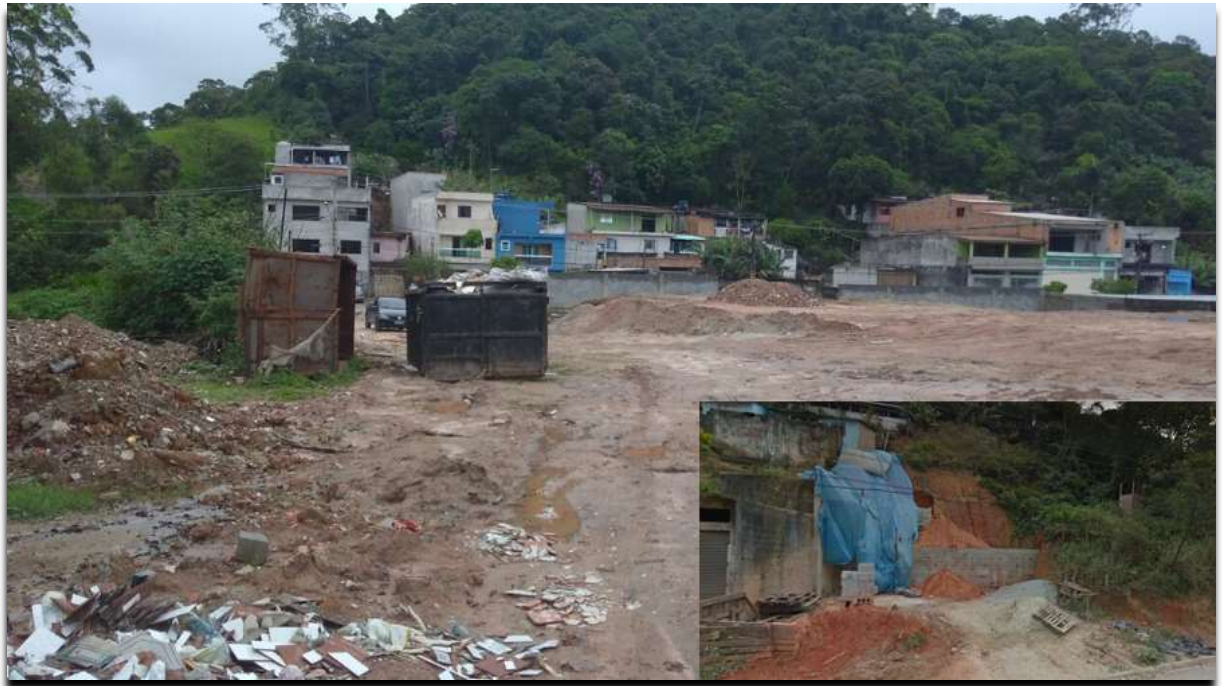
Foto 15 - Obras irregulares no manancial
