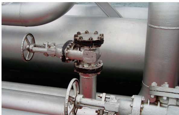
Foto 5.2 – Detalhe da válvula onde houve o vazamento de óleo.
