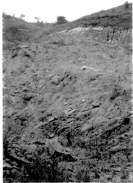
Erosão em taludes em solo.
