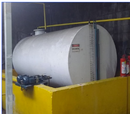
Tanque de óleo diesel
