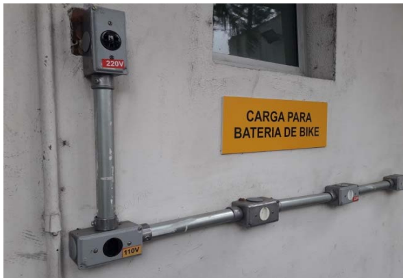
Ponto de recarga para bicicletas elétricas
