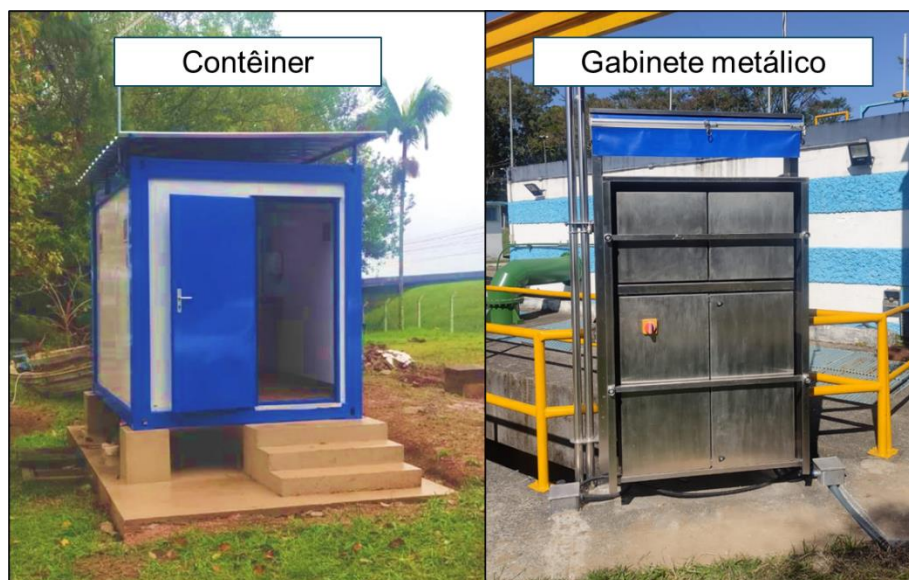
Figura 11 – Exemplos de abrigo para equipamentos de uma Estação Automática
