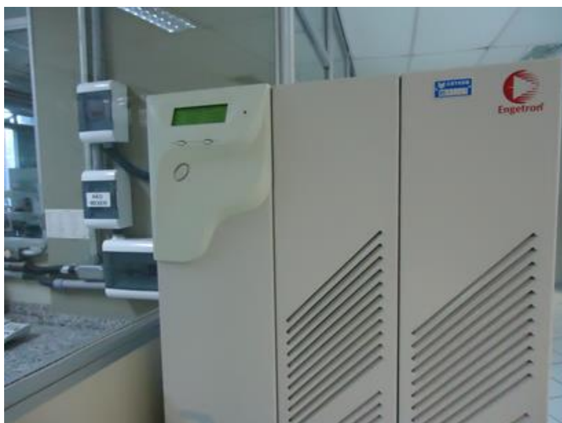
Foto 3. Rede elétrica modernizada e nobreak do LC-MS/MS
