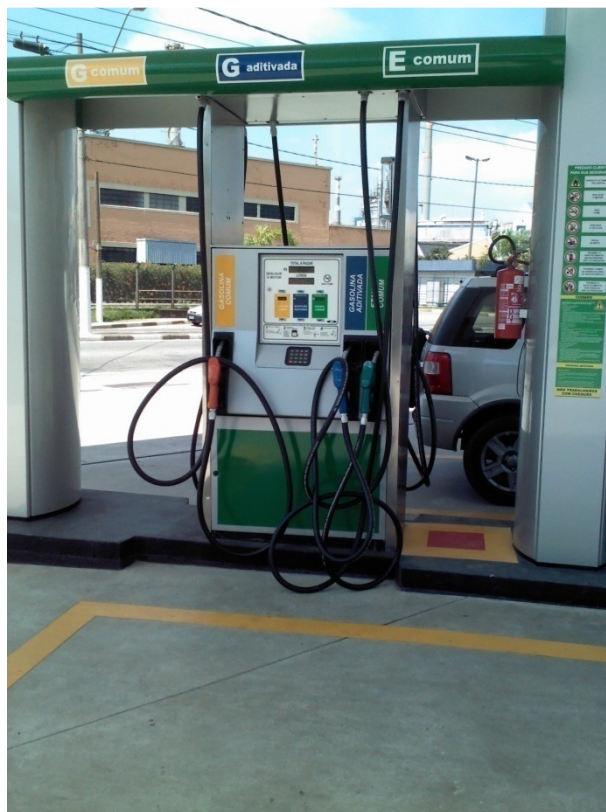
Figura 10 - Unidade de abastecimento instalada. Fonte: Autor (27/01/2014).
