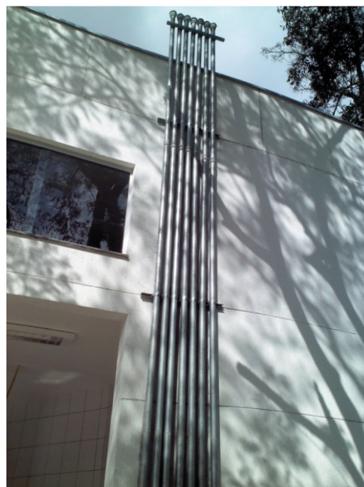
Figura 17 - Tubulação aérea metálica do respiro. Fonte: Autor (19/04/2013).
