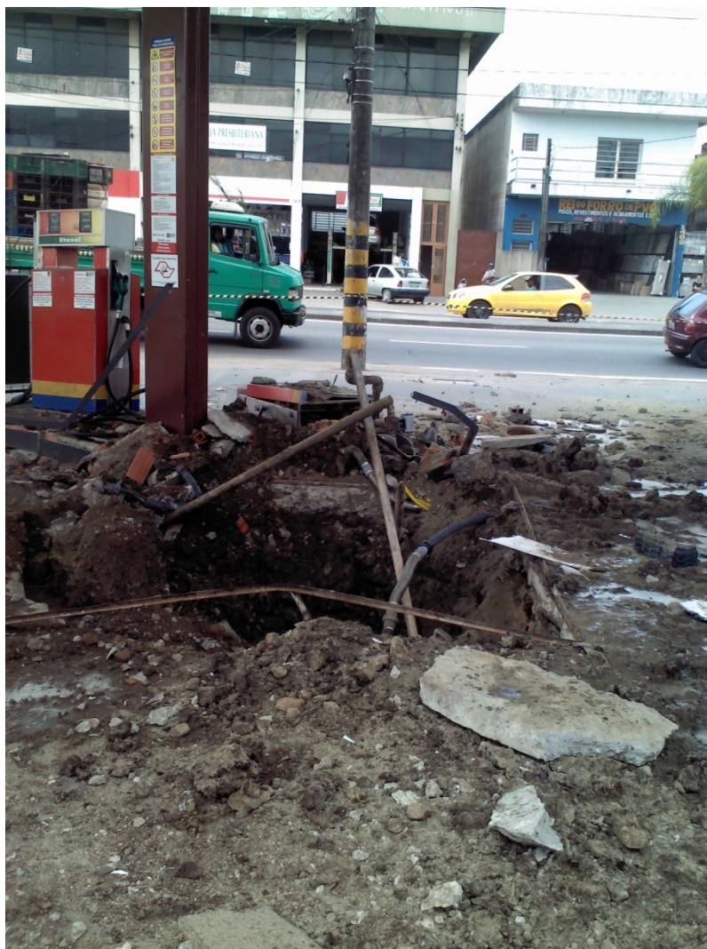
Figura 1- Explosão de um tanque subterrâneo antigo, com o lançamento de tubulações e unidade de abastecimento. Fonte: Autor (20/12/2013).
