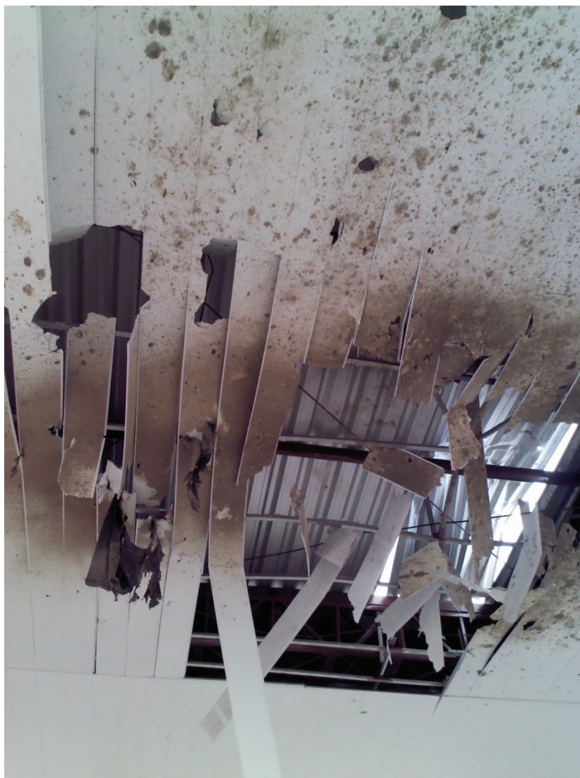
Figura 2 - Cobertura danificada em virtude da colisão da unidade de abastecimento. Fonte: Autor (20/12/2013).
