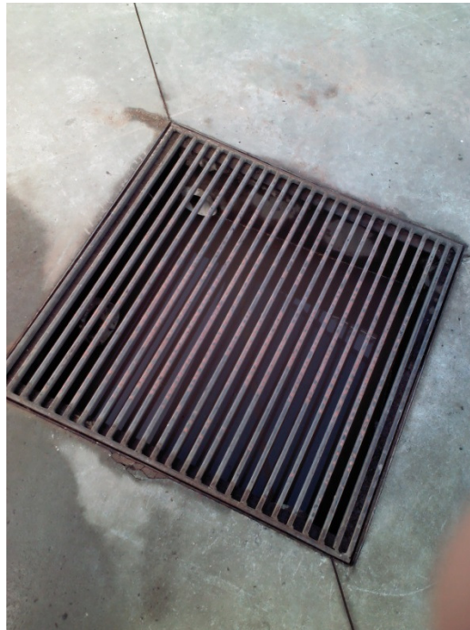
Figura 27 - Caixa de areia. Fonte: Autor (27/01/2014).
