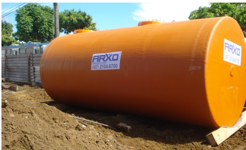
Figura 23 - Tanque para armazenamento de combustível. Fonte: Autor (12/03/2013).
