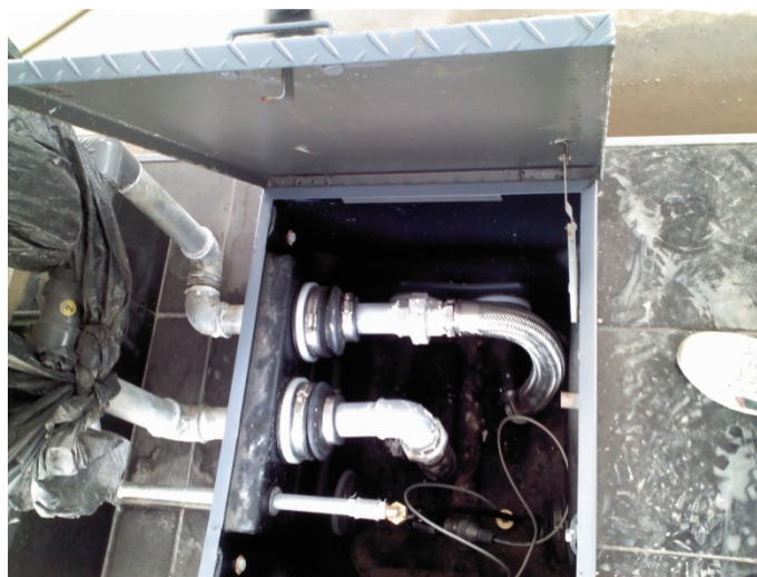
Figura 19 - Câmara de contenção do filtro de diesel. Fonte: Autor (19/04/2013).
