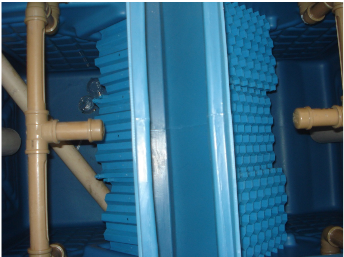
Figura 28 - Caixa separadora água e óleo. Fonte: Autor (12/03/2013).
