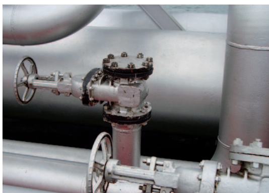
Foto 5.9 – Detalhe da válvula por onde houve o vazamento de óleo.
